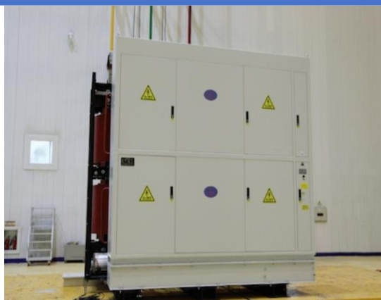
制氢储能用大容量干式整流变压器
