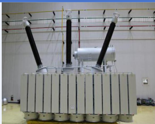
360MVA/330kV 电力变压器
