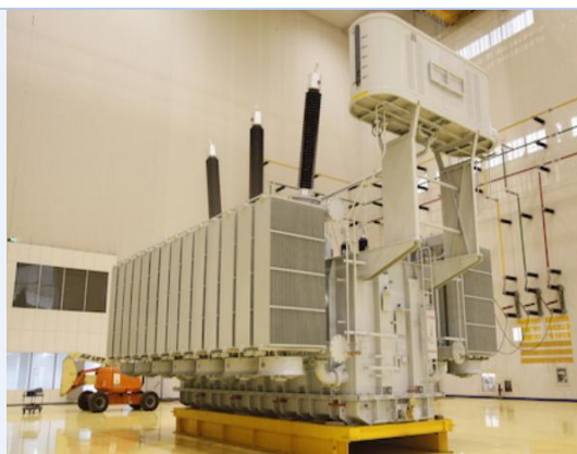
SFSZ11-240000/220 降压电力变压器
